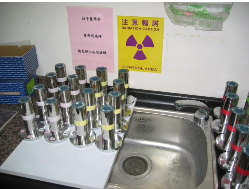
專用放射性廢水槽
