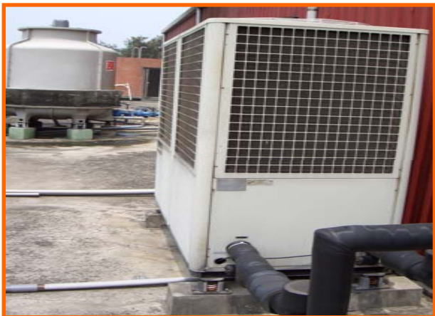
氣冷式冰水機（開關常開）
