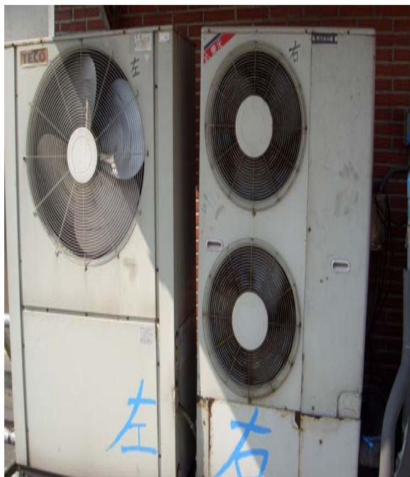
氣冷式冰水機
